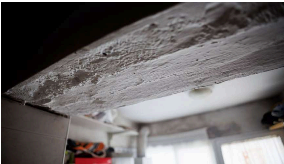
Detalle de la vivienda de Fátima afectada por las obras. MANU GARCÍA
