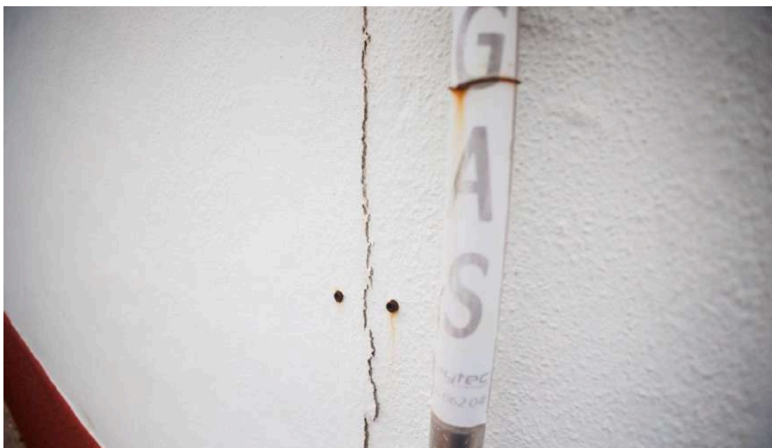
Un bloque con grietas en la fachada. MANU GARCÍA
