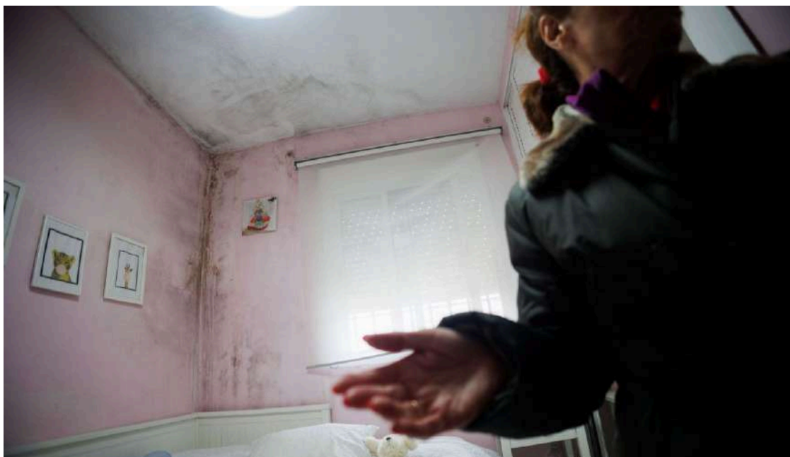
Humedades en la casa de Fátima en El Puerto. MANU GARCÍA
