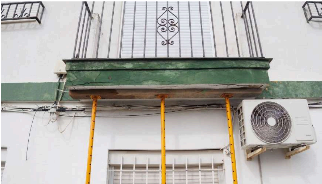
Uno de los balcones que sigue apuntalado. MANU GARCÍA
